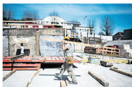
Die Bauarbeiter sind zurzeit meist auf dem Dach des zweiten Untergeschosses beschäftigt. Die Gebäude entstehen von Ost nach West.
