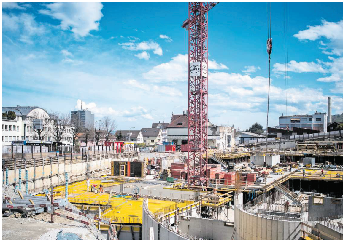
Auf dem rund 120 mal 60 Meter grossen Löwengarten-Areal in Rorschach entstehen Wohnungen und Gewerberäume.
